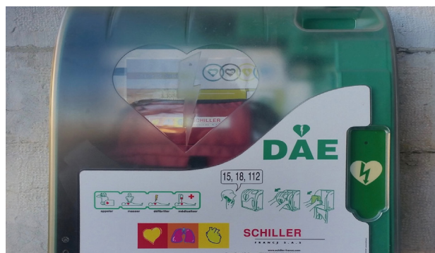
7 défibrillateurs installés sur Brebières
